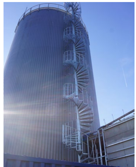
Großtechnischer Fernwärmespeicher zum Ausgleich für fluktuierende Einspeisung, Foto: AEE INTEC
