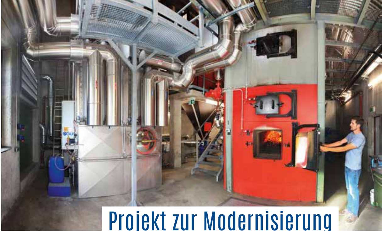
Heizwerk Saalfelden Foto © Klimafonds / Krobath
