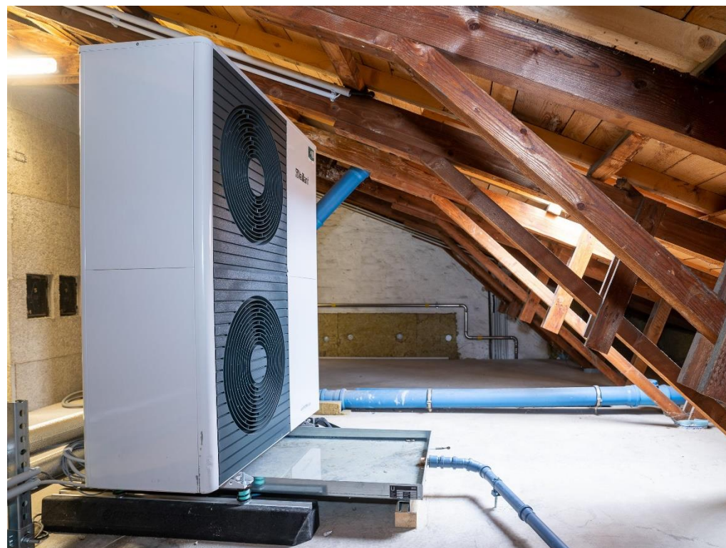
Luftwärmepumpe im Dachraum Quelle Sozialbau AG
