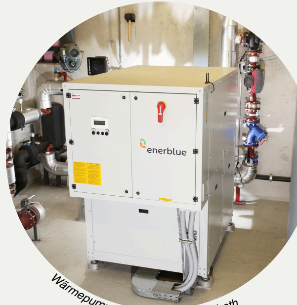
Heizwerk Wald © Salzburg AG
